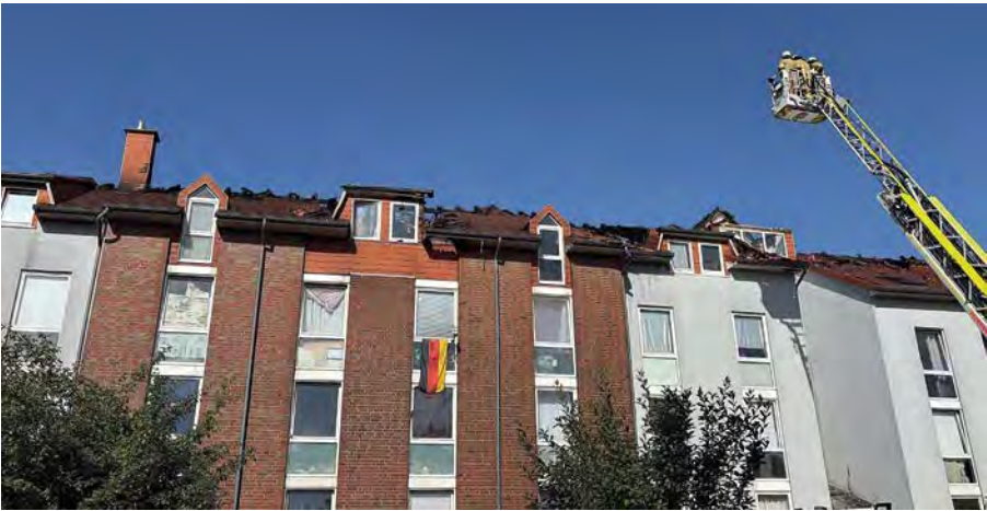
Dachstuhlbrand in Kreyenbrück
